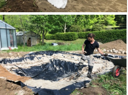
Abb. 5: Andrücken der Teichfolie und Steine entlang der Kanten auslegen, Folienränder in Kapillarrinne versenken
